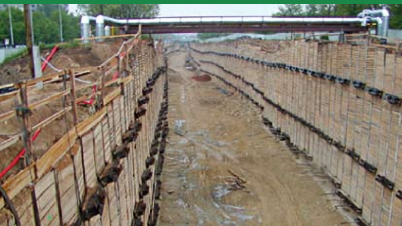
Excavación abierta y corte-cobertura de túneles entre las estaciones Střížkov y Prosek
